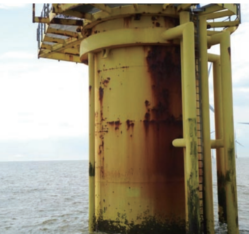
被海水腐蚀的基础
