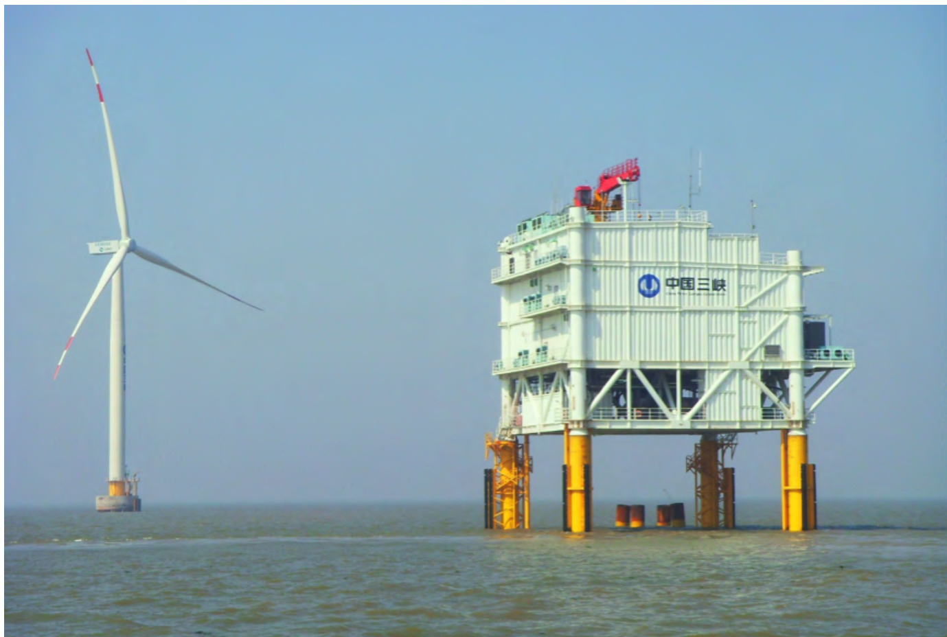
位于响水风电场的亚洲首座220千伏海上升压站
