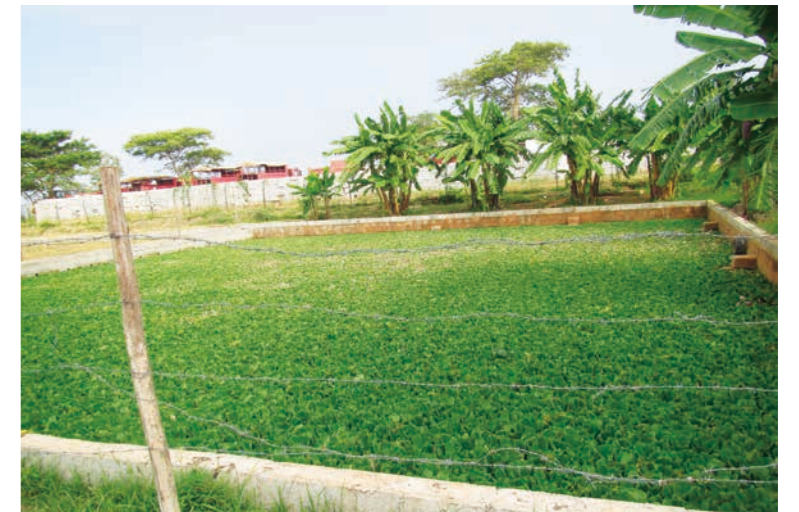
乌干达伊辛巴水电站项目生活污水处理系统
