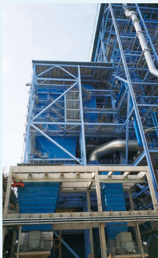
三期工程烟气脱硝装置
